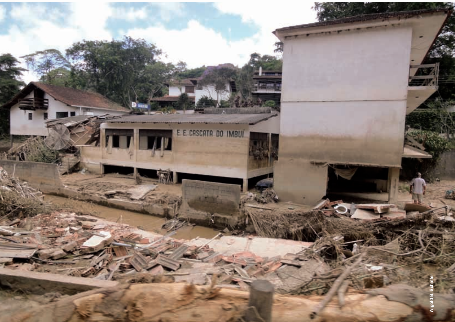
FIGURA 28: Vista da Escola Estadual Cascata do Imbuí em Teresópolis, após a tragédia. A foto mostra a escola, casas e prédios, edificadas em APP, severamente atingidos pela subida das águas. Observa-se também que a canalização do rio não conteve a força das águas. (Foto - 25.01.2011)
